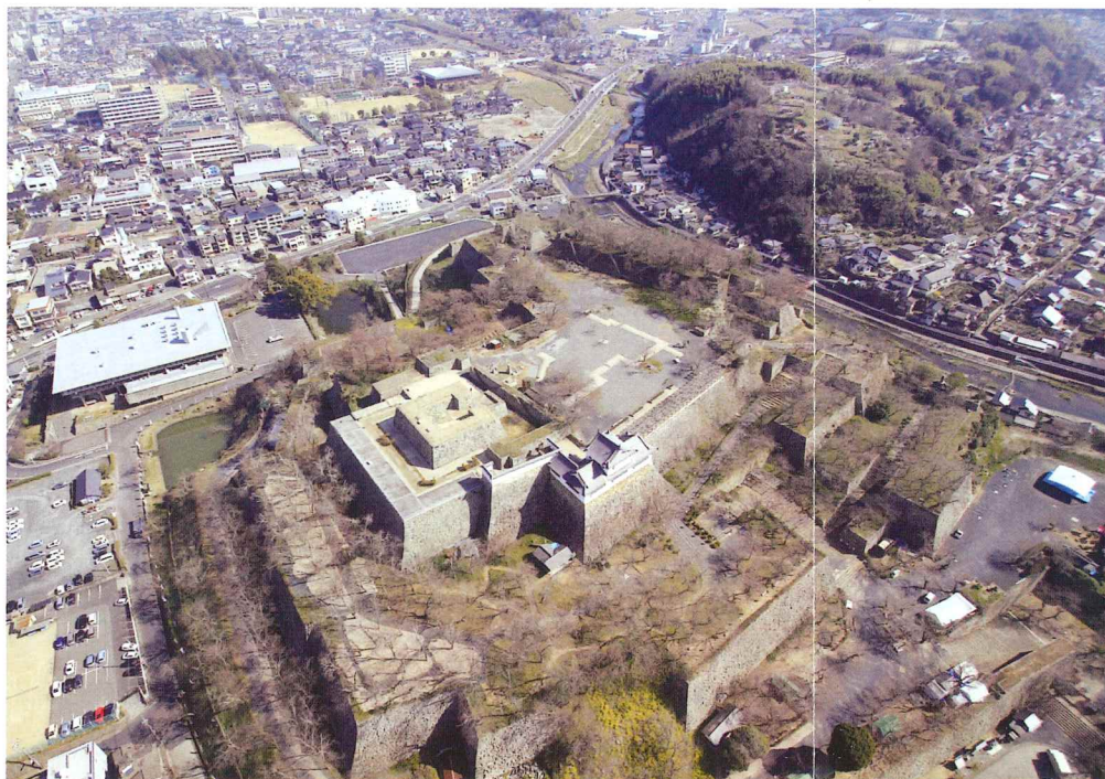
石垣修復現場 石垣修復作業にともない三の丸では一部通行できないエリアがあります。(三の丸から直接「津山文化センター」側へは通り抜けてできません。)
